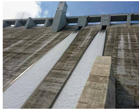
ゲートがなく上部に穴があいているだけで水量調整が困難な伊良原ダム
