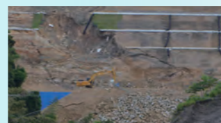
△調整池造成中の土砂崩れ
